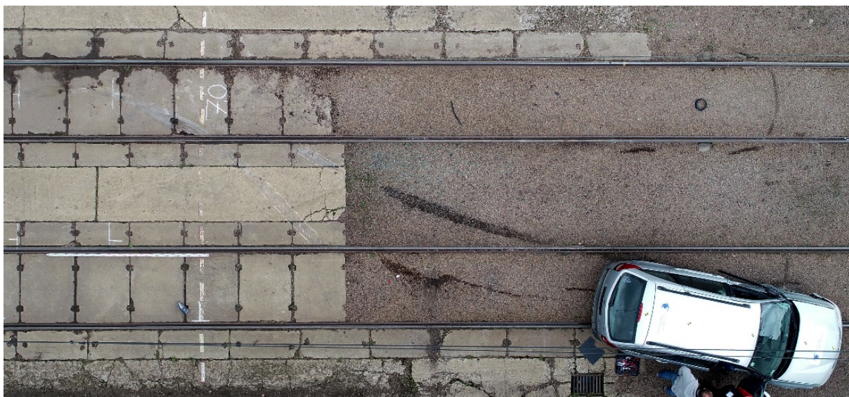
Obr. 16 – Ślady na nawierzchni torowiska. Fig. 16 – Traces on the track surface.
