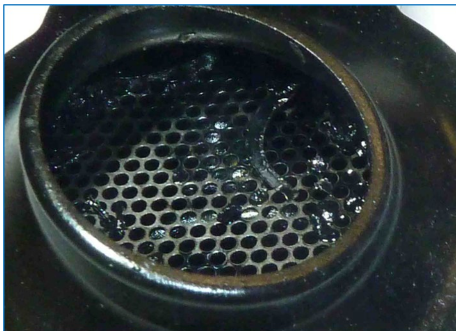
Obr. 18 – Pohled na sací koš Fig. 18 - View of the suction basket
