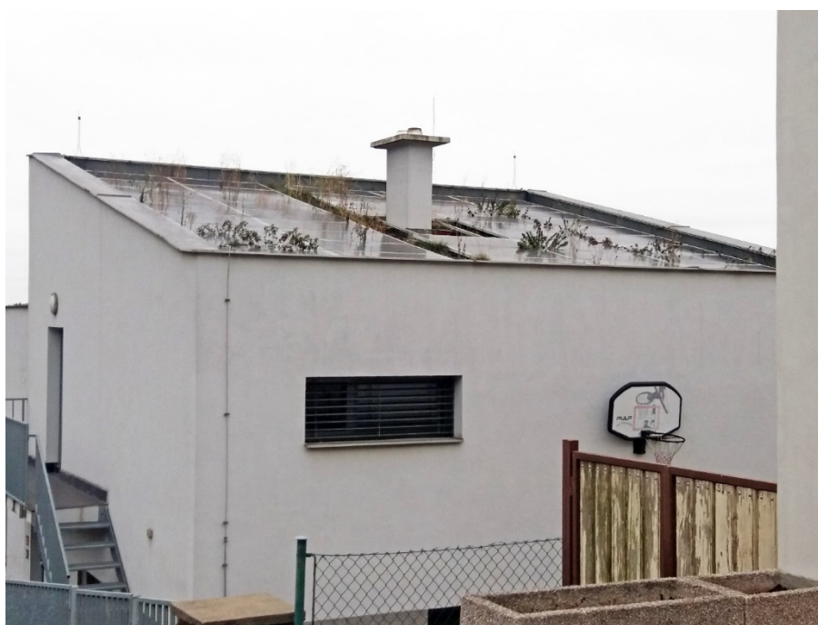
Obr. 7 – Nefunkční kombinace zelené střechy a fotovoltaiky na RD v Praze. Fotovoltaika byla realizována dodatečně přes veškerou zeď, údržba neprobíhá ani nemůže. Foto: GreenVille
