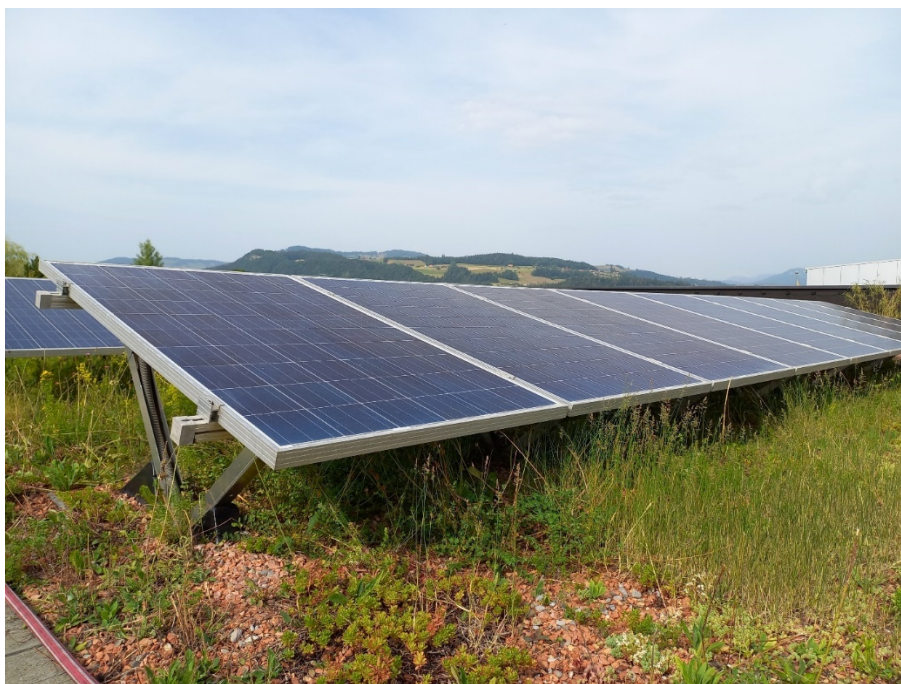
Obr. 3 – Orientace panelů na jih na vyvýšené konstrukci. Zdroj: archiv autora
