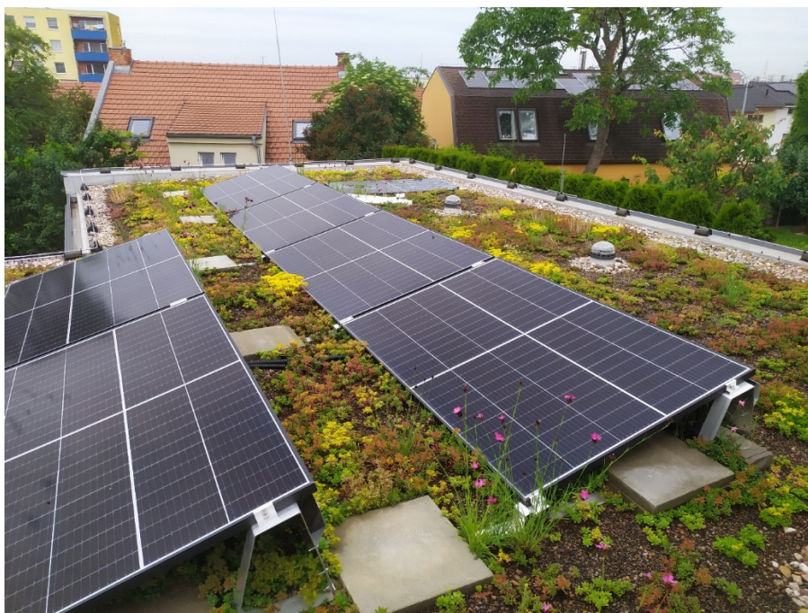
Obr. 2 – Takto dodatečně instalovaná fotovoltaika přes zelenou střechu je špatné řešení vzhledem k vysokému riziku zastínění panelu. Zdroj: GreenVille
