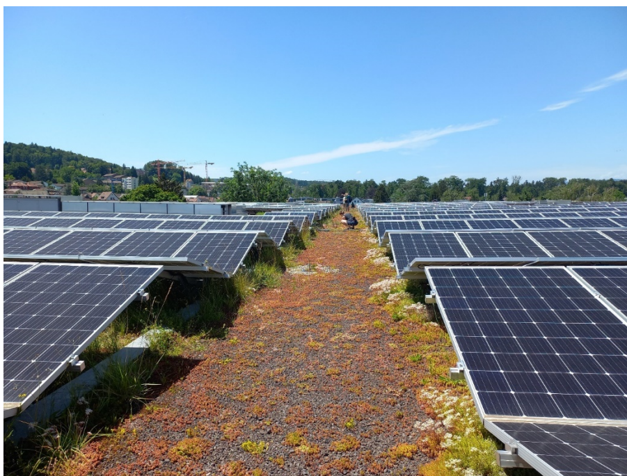
Obr. 4 – Orientace panelů východ-západ na vyvýšené konstrukci. Zdroj: archiv autora
