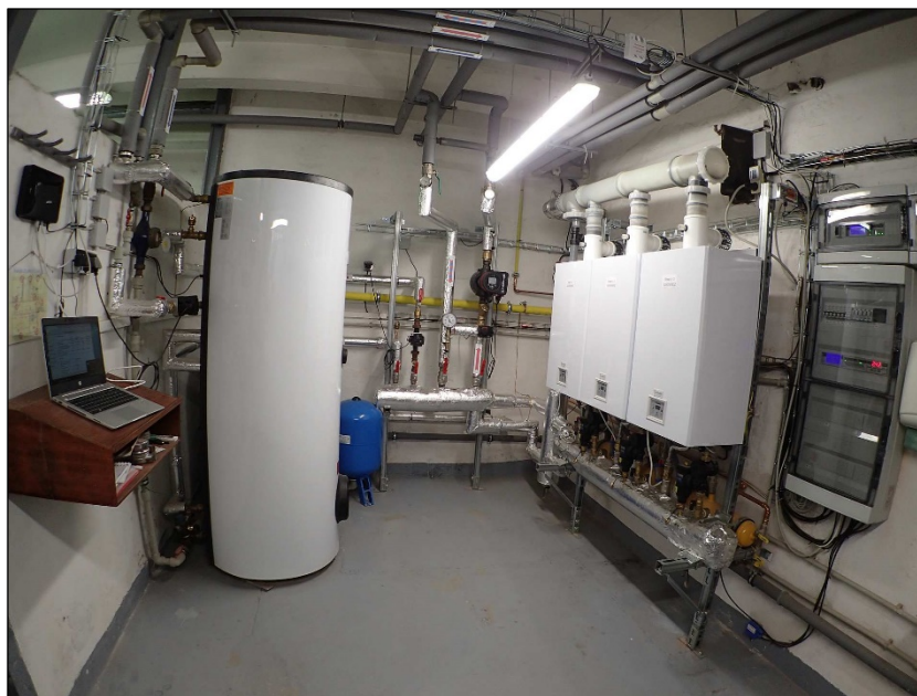
Obr. 5 – Kaskáda tří kotlů THERM 24 KDN (2021) Fig. 5 – Cascade of three boilers THERM 24 KDN (2021)
