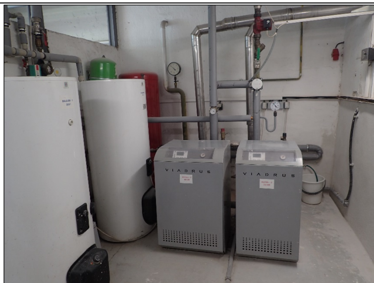
Obr. 3 – Instalace dvou kotlů Viadrus (2007)
