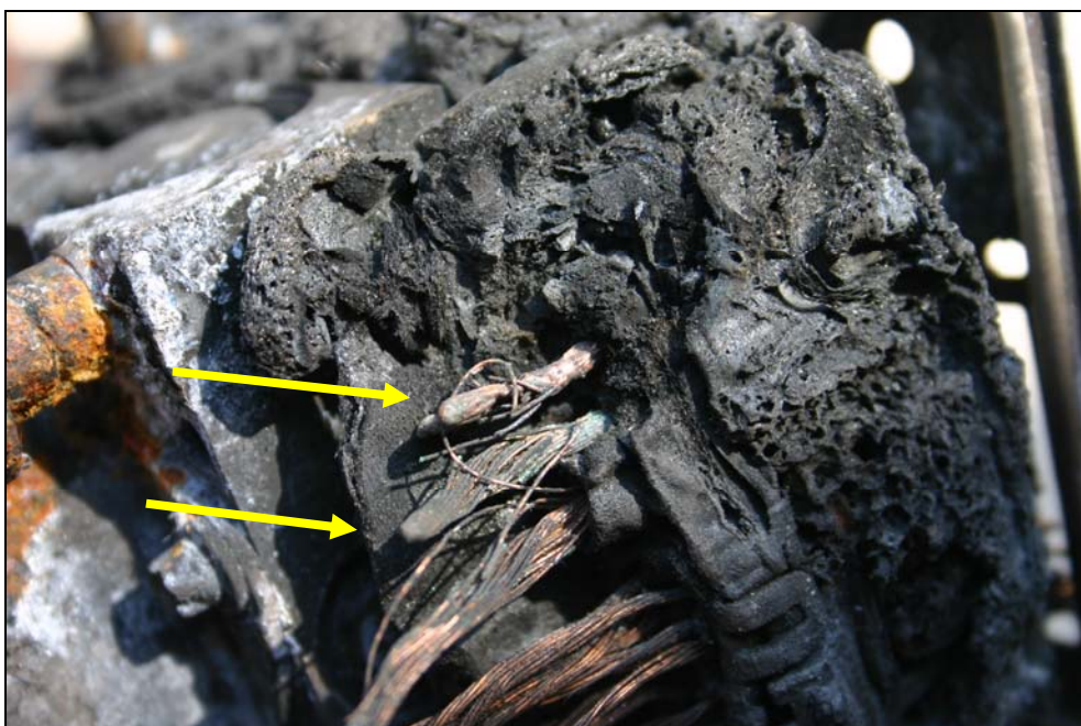
Obrázek 43 - Pohled na zkratem poškozené vodiče u kterých došlo k jejich přerušení.
