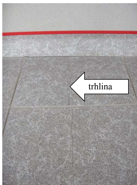
Foto č. 5 Odtržení soklu a trhlina v dlažbě ve foyeru v 3. NP
