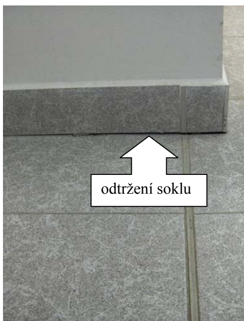
Foto č. 4 Odtržení soklu v podlaze vstupního vestibulu
