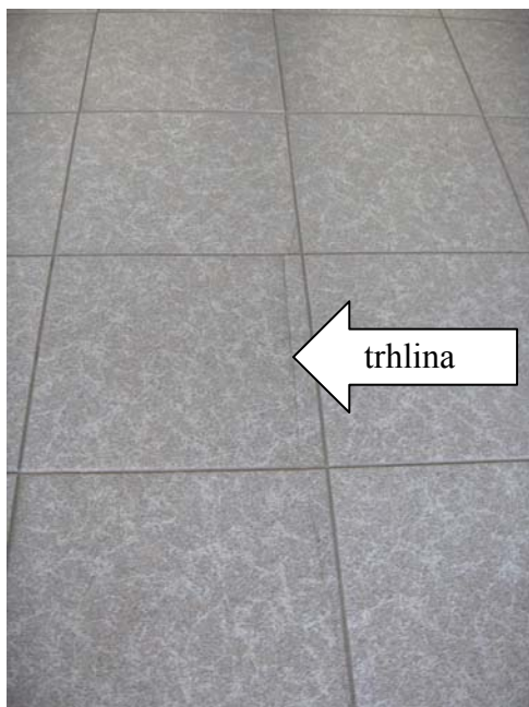
Foto č. 2 Trhlina v podlaze vstupního vestibulu
