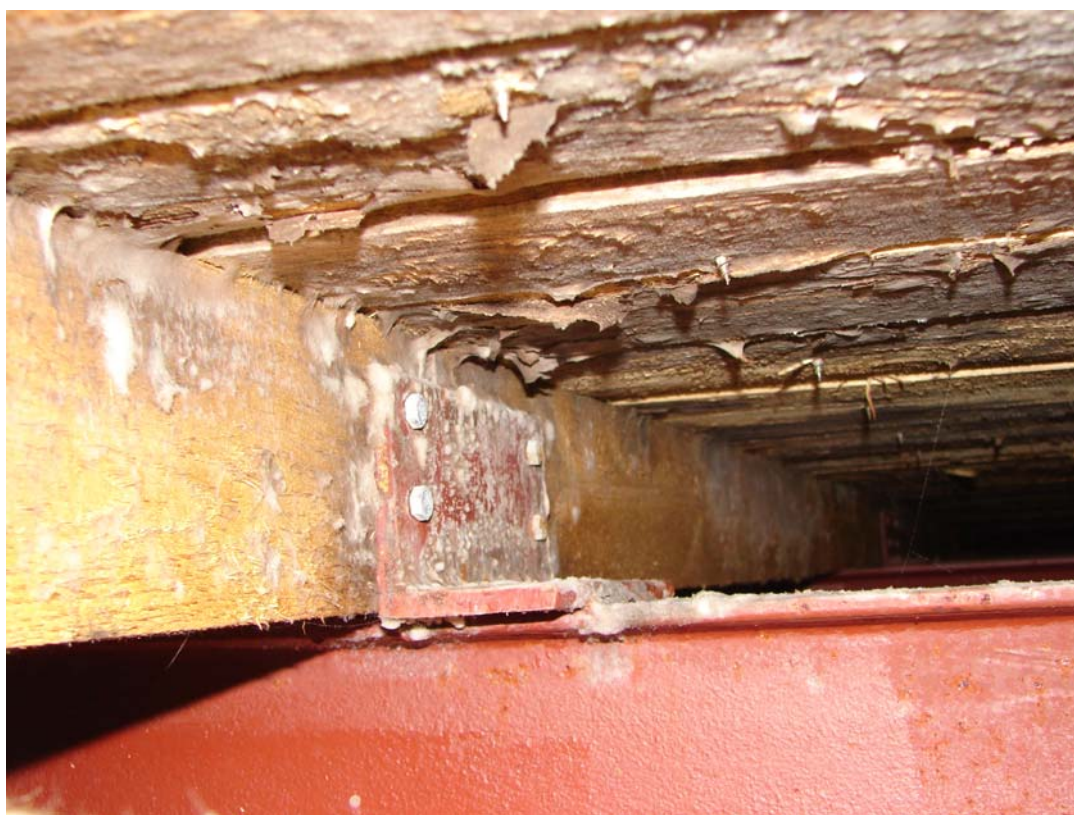
Foto 4 – Detail biologické koroze dřevěných prvků střechy v mezistřeším prostoru nad koupelnou
