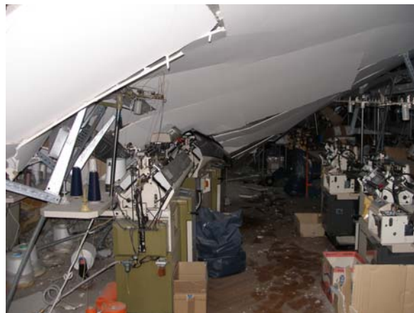
Foto č. 2 - Snímek zřícené střešní konstrukce těsně po její havárii střechu zevnitř objektu
