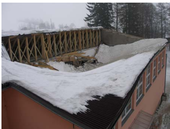
Foto č. 3 - Ranní snímek zachycující stav po havárii střechy
