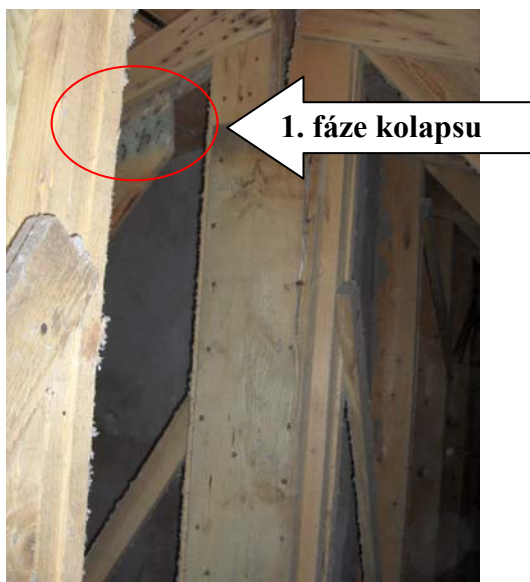
Foto č. 5 - Vytržená diagonála z horního krajního styčnicku krajního vazníku
