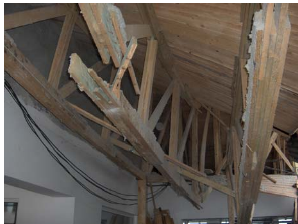
Foto č. 8 - Nezřícené ale silně porušené vazníky
