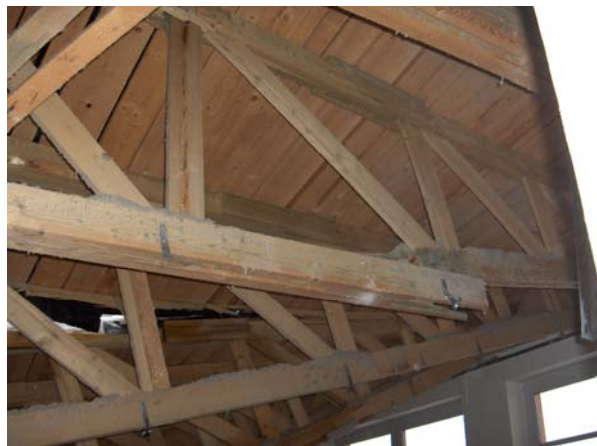
Foto č. 7 - Vazník se zlomeným spodním pásem v místě styčnicku
