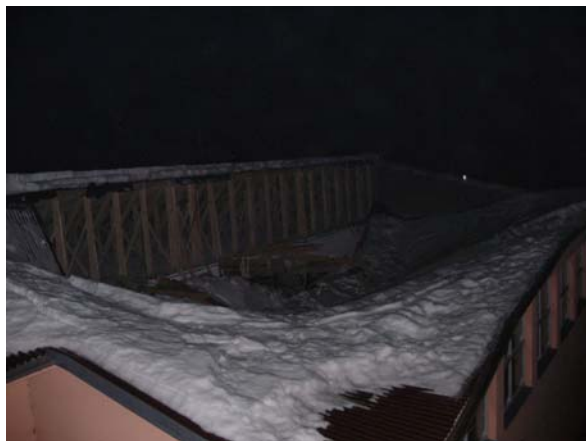
Foto č. 1 - Noční snímek zachycující stav těsně po havárii střechy
