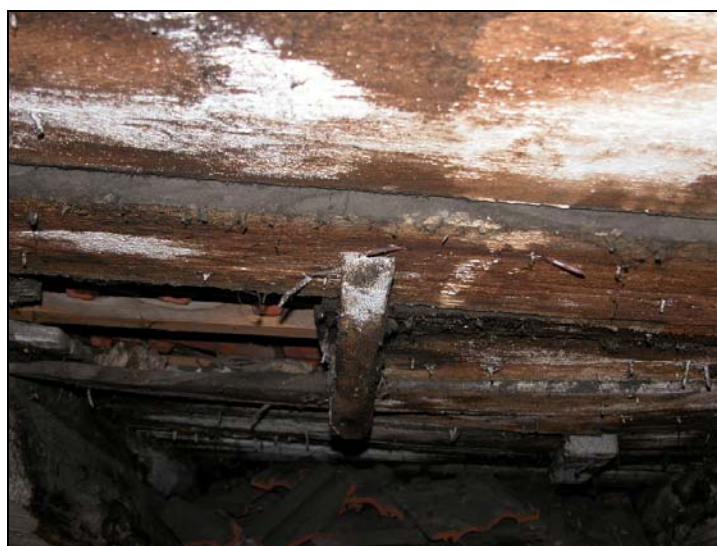
Obrázek č. 1 – Prohnutí latí mezi 3. a 4. krokví, část podbití vyříznuta
