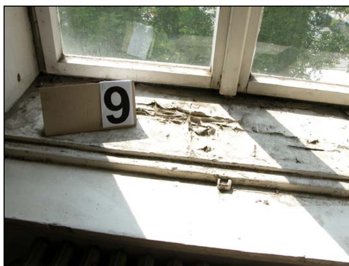
Obrázek č. 4 – Právě okno kanceláře, poškození vnitřního parapetu zatékáním (4.NP)
