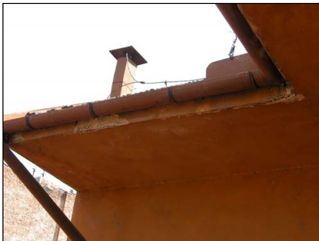
Obrázek č. 5 – Zatékání na okapovou římsu
