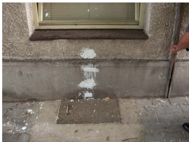
Obrázek č. 5 - Trhlina pod oknem místnosti, kde se zřítíla klenba
