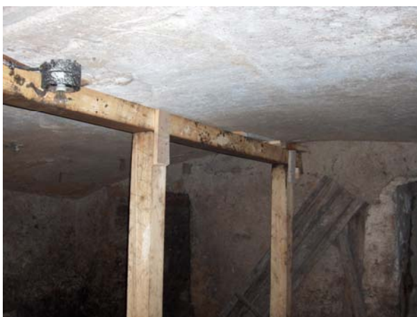
Obrázek č. 3 - Poškozená klenba v sousední místnosti
