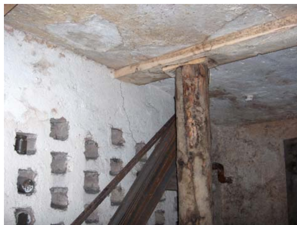
Obrázek č. 6 - Trhlina v příčce pod sousedním klenbovým polem
