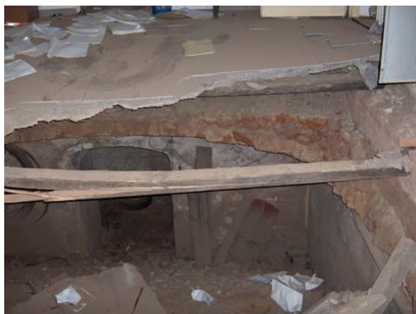
Obrázek č. 1 - Havarovaná klenba
