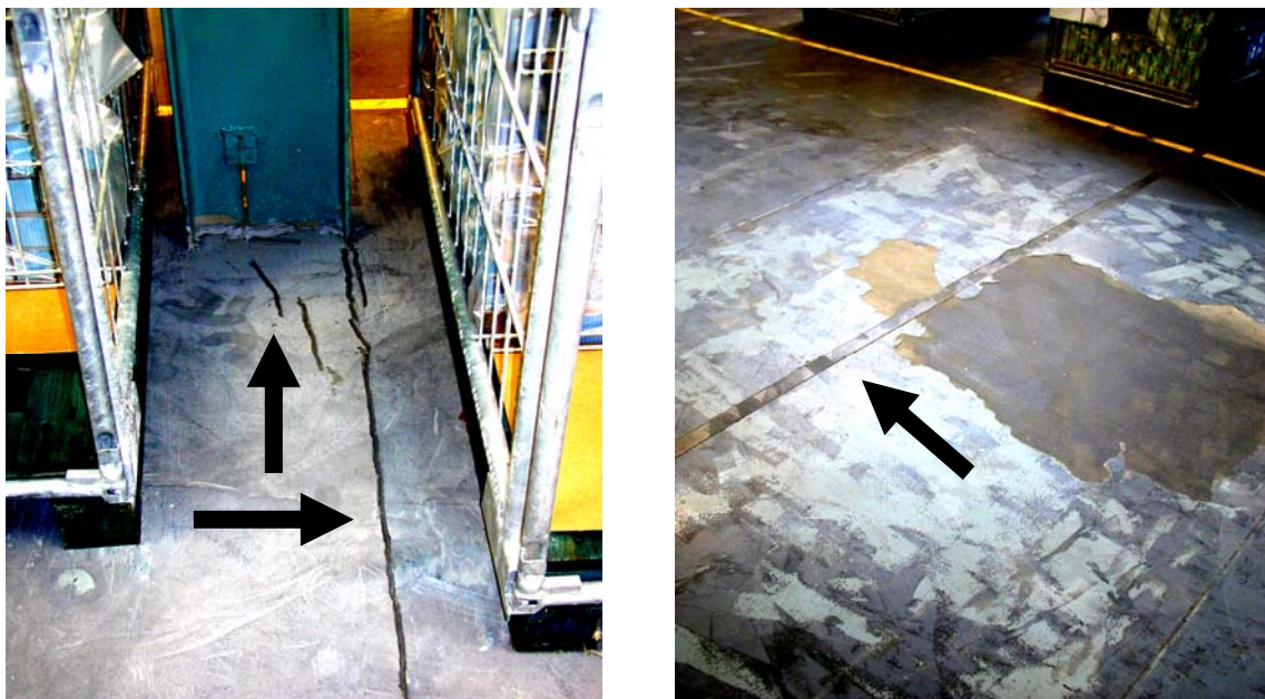
Obr. 1: Poruchy podlahových desek v poli
