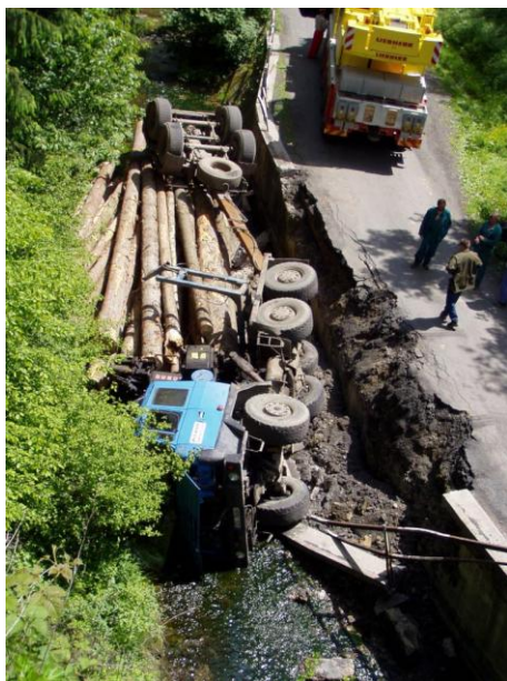
Foto č. 1 – Havárie odvozní soupravy
