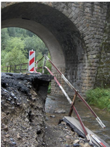
Foto č. 2 – Na fotografii je patrné značné naklonění nábřežní zdi
