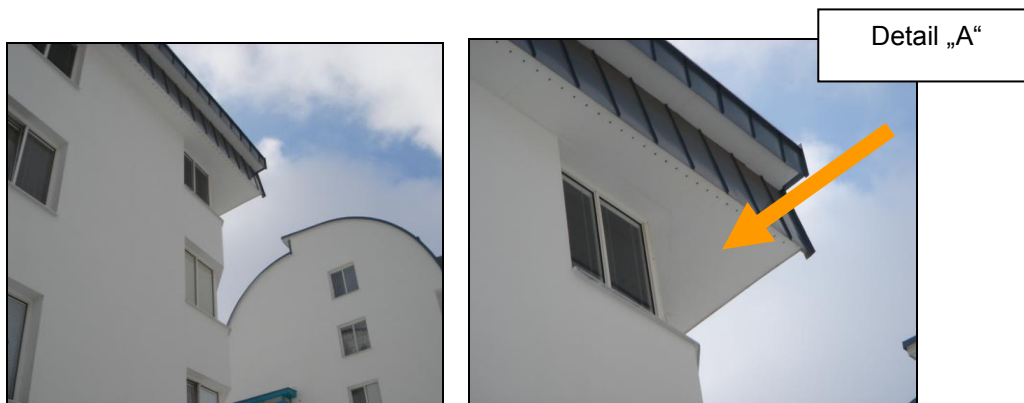
Obrázek č. 2 – Atypický tvar zastřešení bytového domu a část ochlazované podlahy (Detail „A“)
